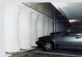
Defectos de diseño
