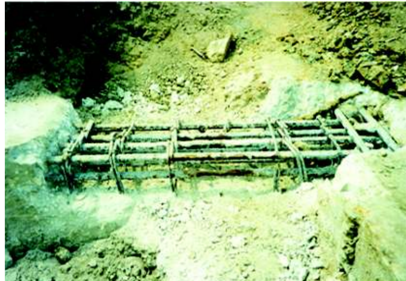
Corrosión de armadura por deficiente adherencia entre concretos y/o falta de sello en junta fría o de construcción en viga de cimentación.
