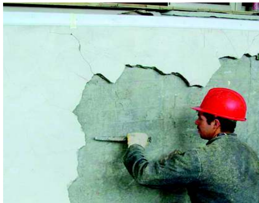
Falla de adherencia de mortero aplicado sobre concreto.
