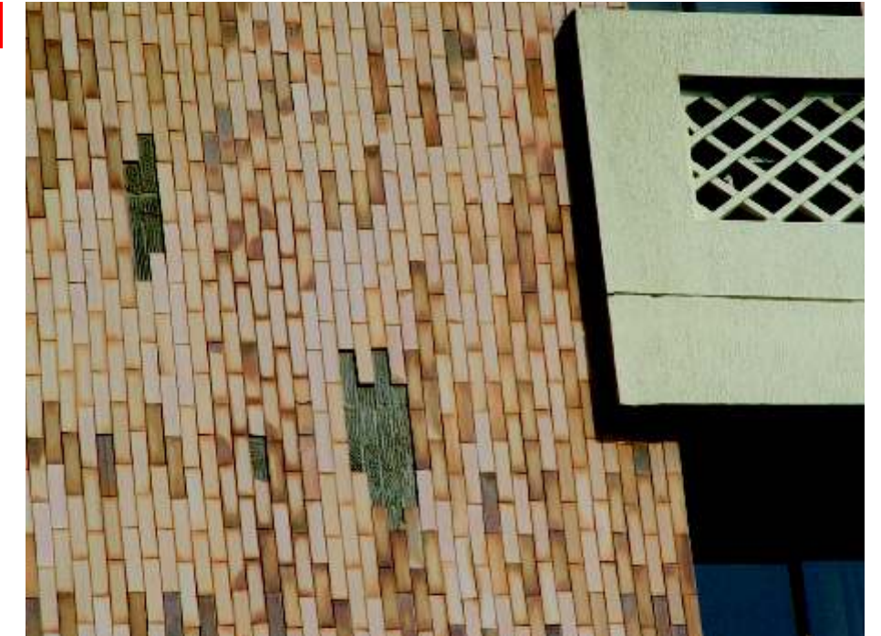
Fallas de adherencia en enchape de fachada
