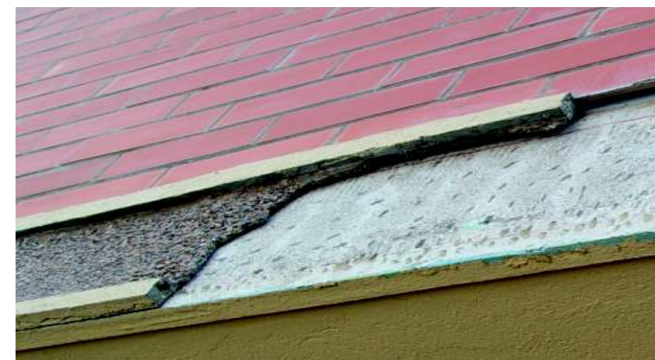
Desprendimiento de mortero en fachada a pesar de haber "preparado la superficie" por picado y haber saturado con agua.
