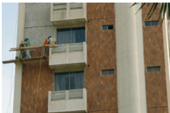
Foto No.2: Retiro de los elementos de fachada debido a desprendimientos causados por ausencia de juntas de dilatación.
