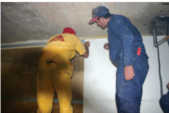
Tanque Aeropuerto El Dorado, Bogotá
