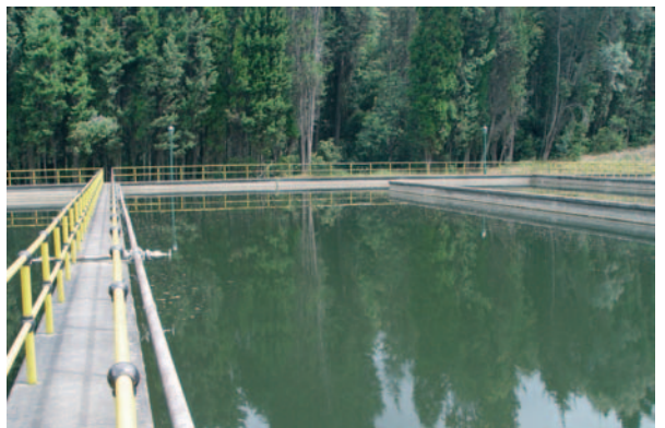
Tanque para agua potable, Bogotá
