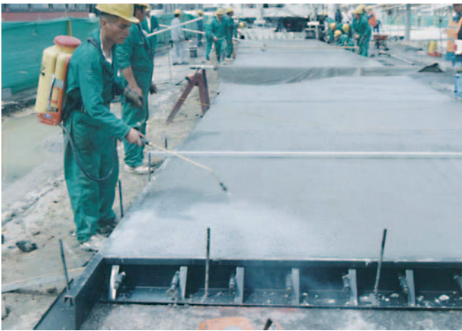
Foto No.2: Aplicación de un compuesto de curado por aspersión. Nótese que para controlar el impacto del viento se cubre el concreto recién curado con lonas, una vez el compuesto de curado seque al tacto.
