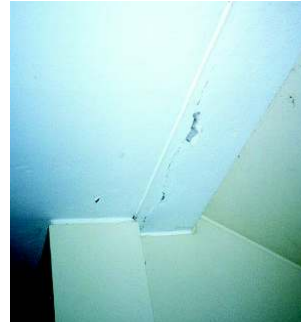
Deficiente conformación y funcionamiento de junta en edificio
