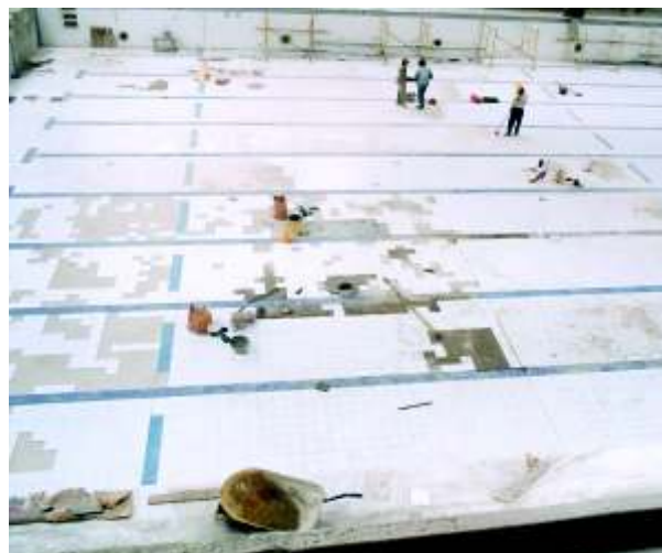
Falla de adherencia en enchape de piscina por ausencia de juntas en mortero de pega y nivelación
