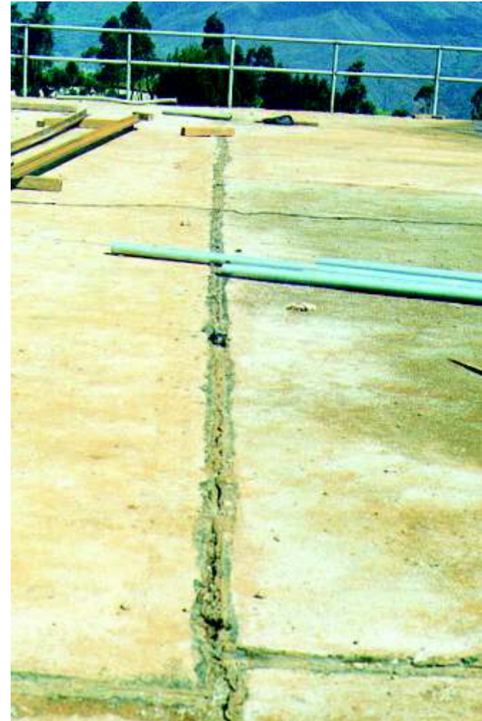
Falla del sellante plástico bituminoso en losa de pavimento por envejecimiento
