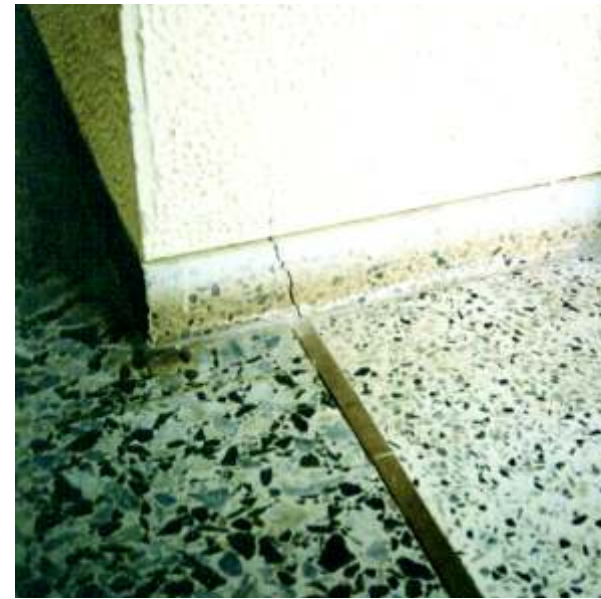
Deficiente conformación y funcionamiento de junta en edificio
