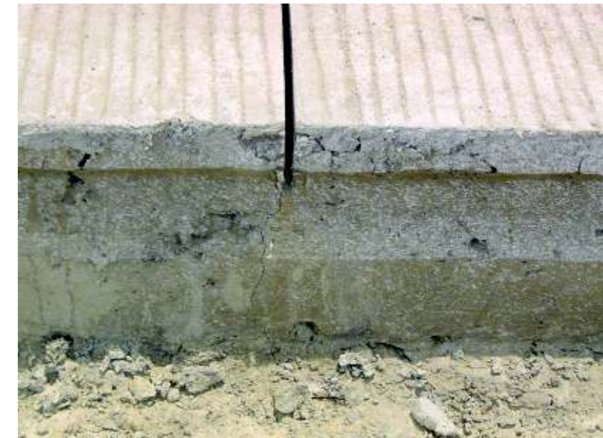
Junta de control, inducida o aparente en losa de pavimento de vía
