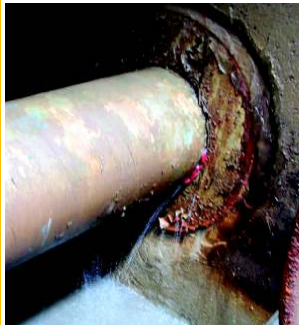
Filtración por junta entre tubo metálico y muro de concreto
