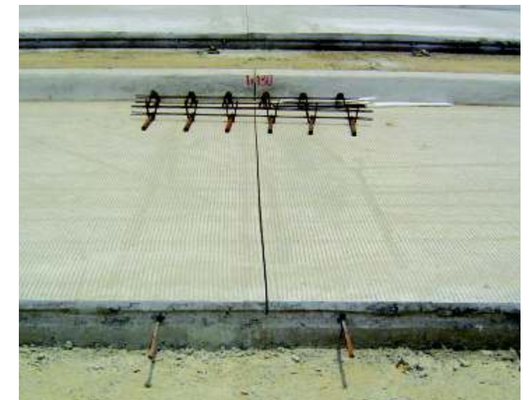
Pasadores metálicos y junta de control o inducida en losa de pavimento de vía
