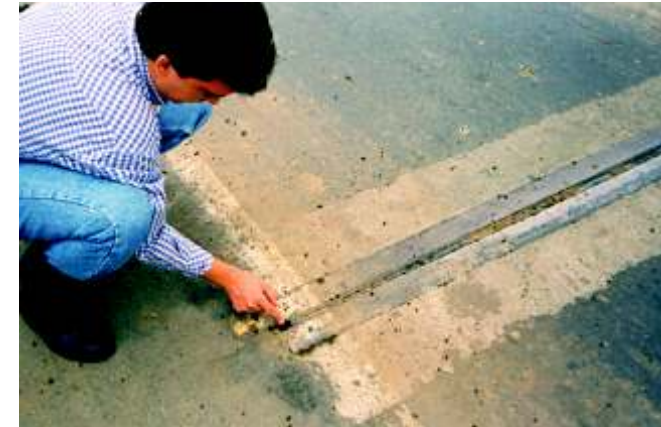
Deficiente conformación y funcionamiento de junta en tablero de puente ampliado
