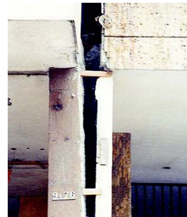
Juntas de separación entre edificios luego de un sismo
