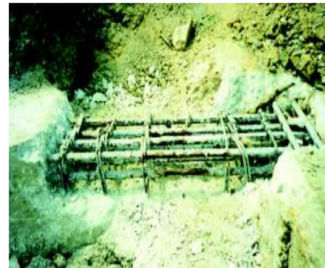
Corrosión de refuerzo por falta de sello en junta fría o de construcción en viga de concreto
