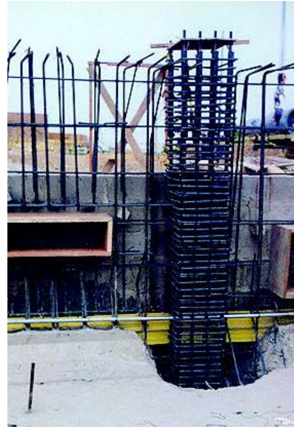
Sellado de junta entre losa y muro de concreto con sello de PVC
