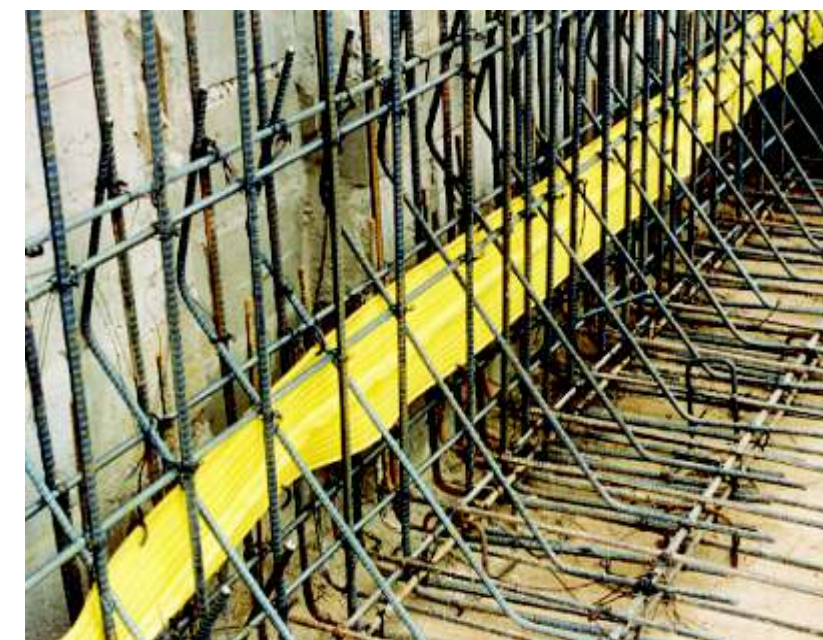
Sellado de junta entre losa y muro de concreto con sello de PVC
