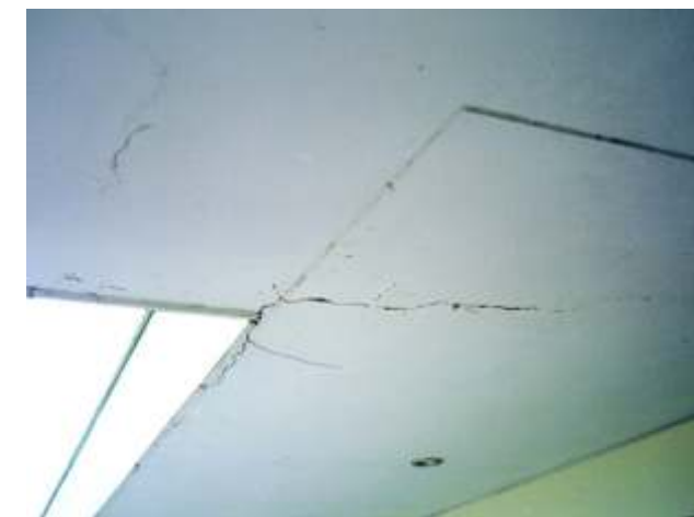
Deficiente conformación y funcionamiento de junta en losa de edificio
