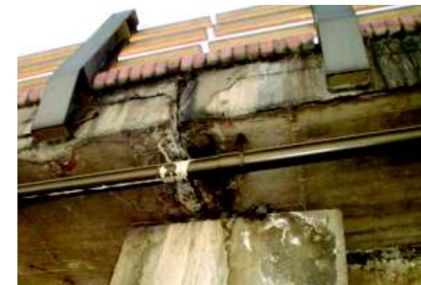
Deficiente funcionamiento de junta en puente, manchas por lixiviación o lavado del concreto.
