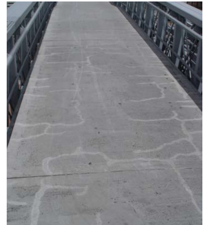
Foto No. 11: Fisuramiento por contracción de secado en losa de puente peatonal.
