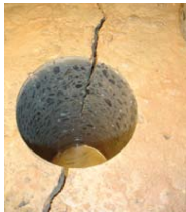
Foto No. 13: Cimentación fracturada probablemente por contracción térmica inicial, ya que se descartó punzonamiento.
