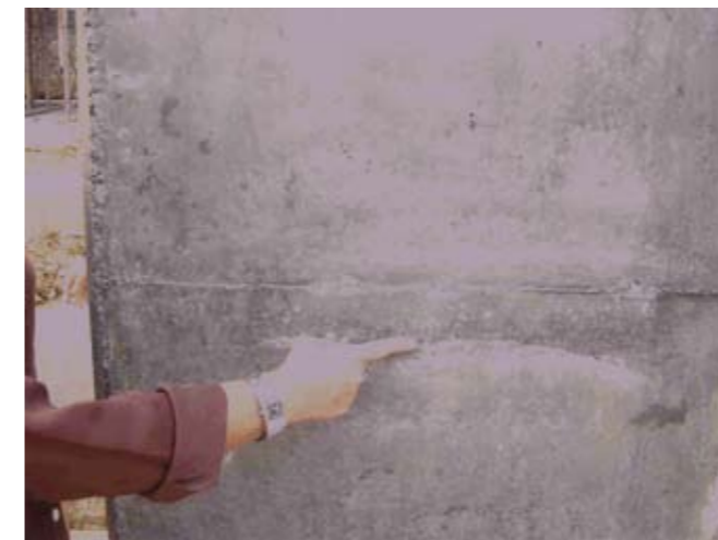
Foto No. 14: Fisuramiento de columna debido al choque térmico.
