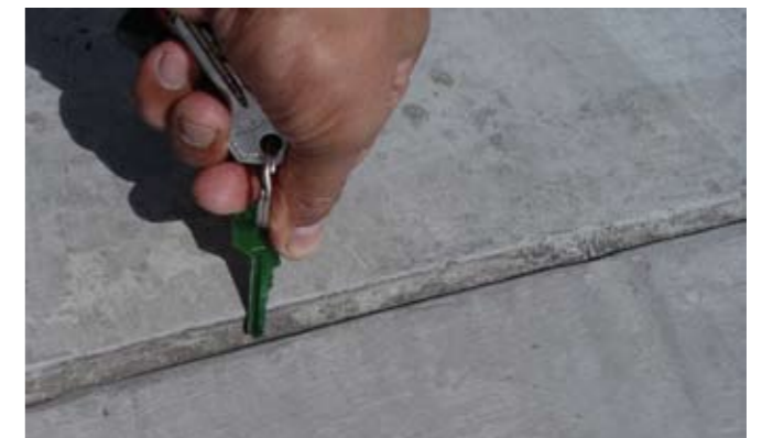
Foto No. 12: Aparentemente existen juntas de dilatación/contracción en esta estructura, pero no trabajan debido a su escasa profundidad.
