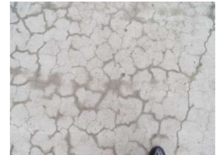
Foto No. 8: Agrietamiento por contracción plástica, que se hace más visible cuando la estructura se moja.
